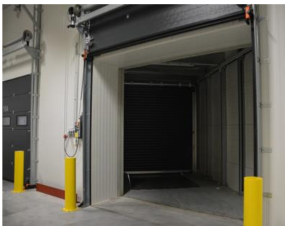
Abbildung 1: Thermo-Tor im Kühllager bei Grieshaber Logistics Group AG
