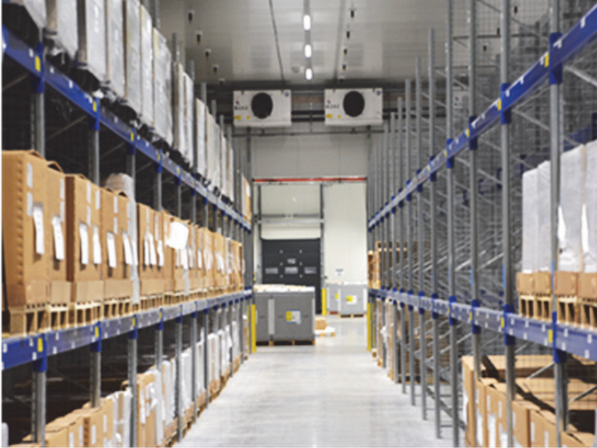
Abbildung 12 KÜHLLAGER (2–8 °C) bei Grieshaber Logistics Group AG
